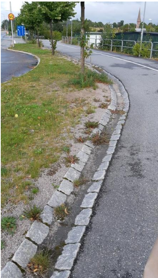
Figur 32. Exempel på dagvattenränna (Tyréns, 2021)
